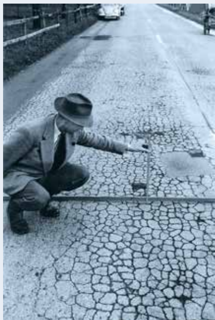
Die Schadensaufnahme an der Hauptstrasse Bern-Thun im Jahr 1947 zeigt den in den Jahren nach dem Krieg häufigen Befund: bei vielen Strassen brechen die Tragschichten und Beläge zusammen. Grund genug, um ein Forschungsprojekt zu initiieren.
