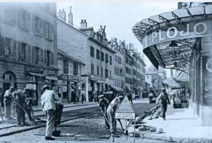
Herstellung des aus zwei Lagen bestehenden Asphaltbelags («Mexphalte») in der Genfer Rue de Carouge im Jahr 1927 (Foto: Archiv Josef Murmann).
